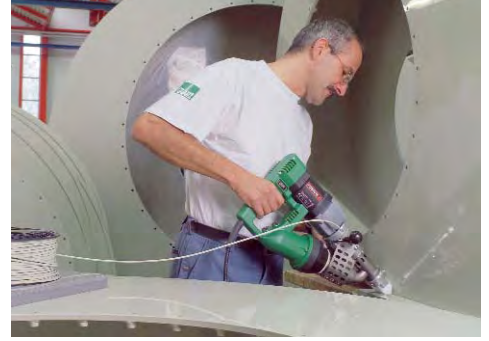
FUSION 2 käytössä säiliön rakennuksessa.
